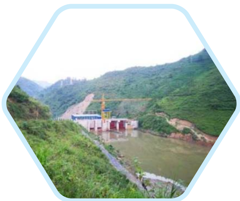
THỦY ĐIỆN SÔNG NHIỆM 4
