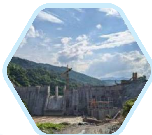
THỦY ĐIỆN SÔNG NHIỆM 3
